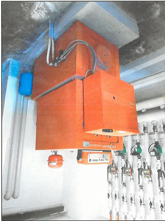
– GENERATORE DI CALORE CENTRALIZZATO IN CENTRALE TERMICA –
